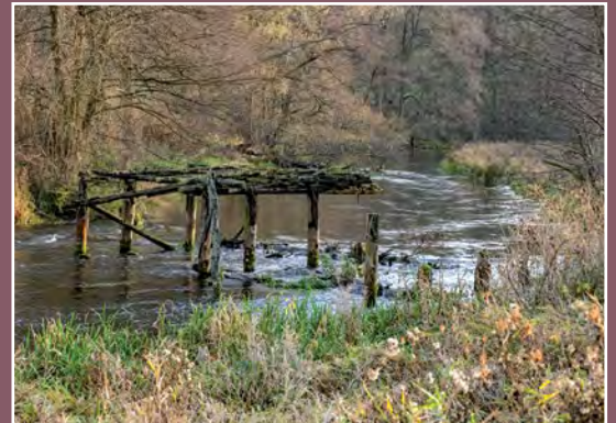
Spalony most w Zabrodziu Verbrannte Brücke in Gramattenbrück
